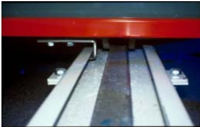
圖二 成大圖書館地下二樓密集書架之軌道
