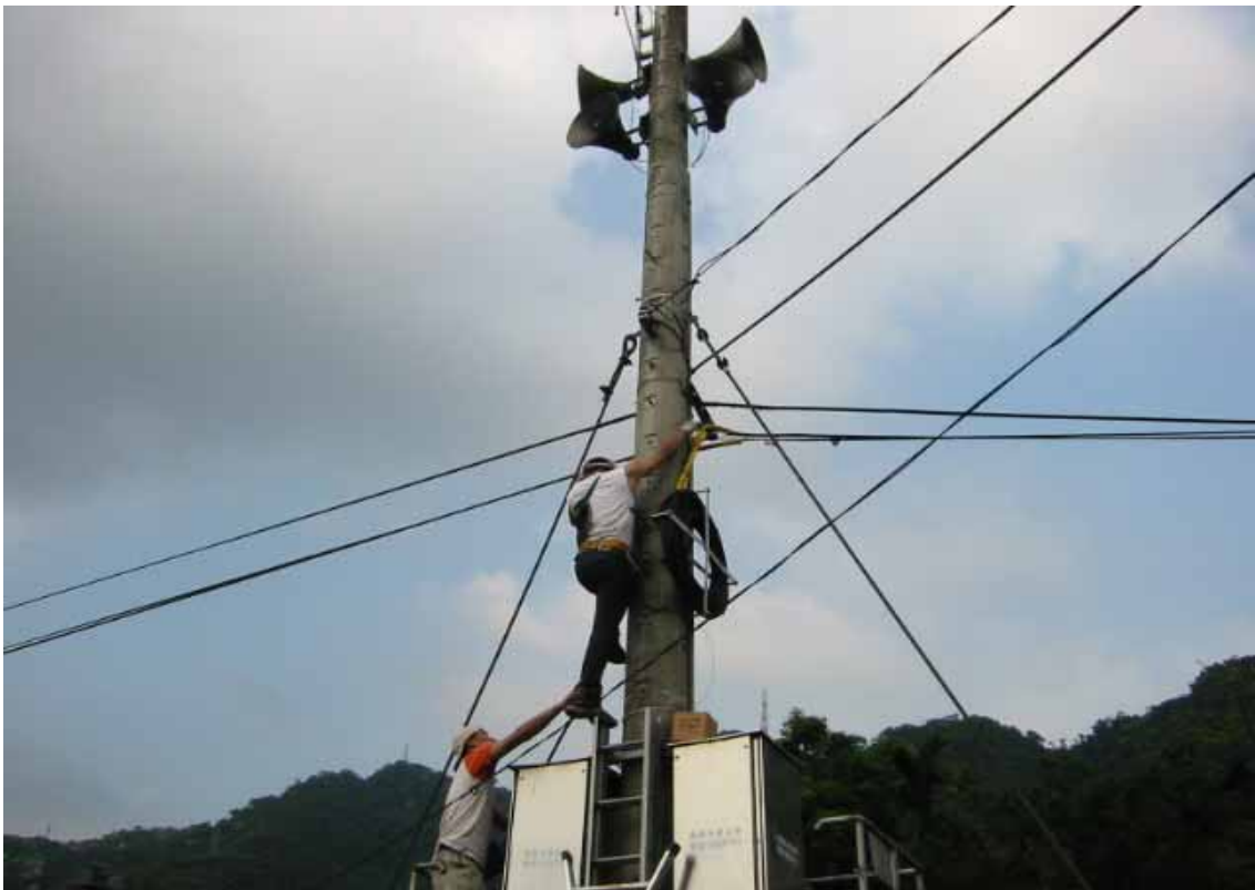
洩洪警報站平時維護作業
