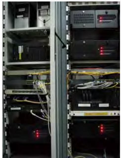
圖4 行控中心錄影系統伺服器設備
