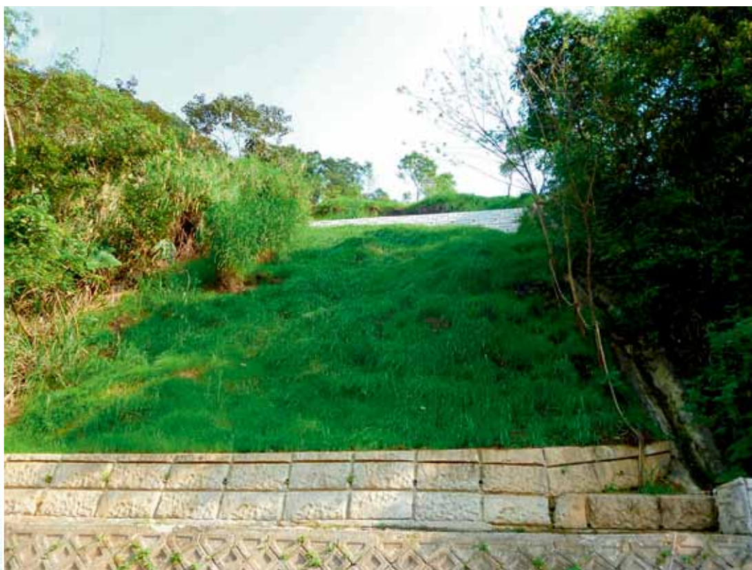
▲道路崩塌處擋土牆、邊坡綠化植生
