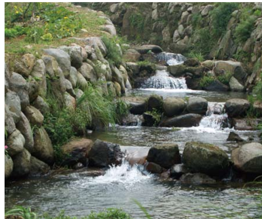
↑「固床工」是溪溝整治生態工程重要的手段，兼具安全、生態、美觀、休憩等多元功能。
