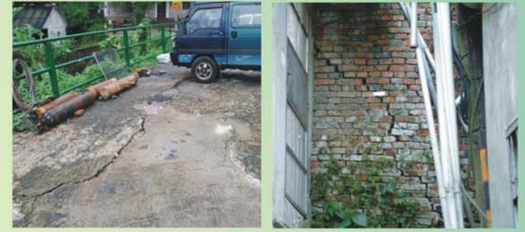
▲ 房屋龜裂：淺層滑動造成房屋變形龜裂
