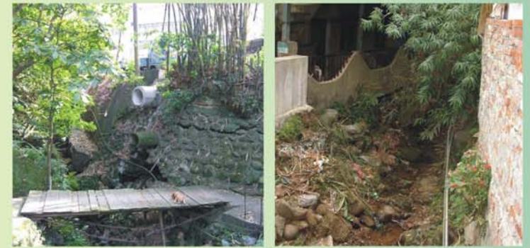
▲ 溪岸基礎淘空破壞：既有構造物基礎遭溪水淘空， 造成變形
