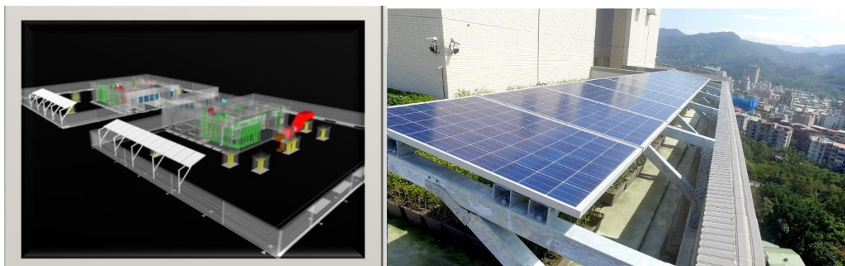
圖 4-1、綠色公共用電微電網之太陽光電發電系統現場實景
