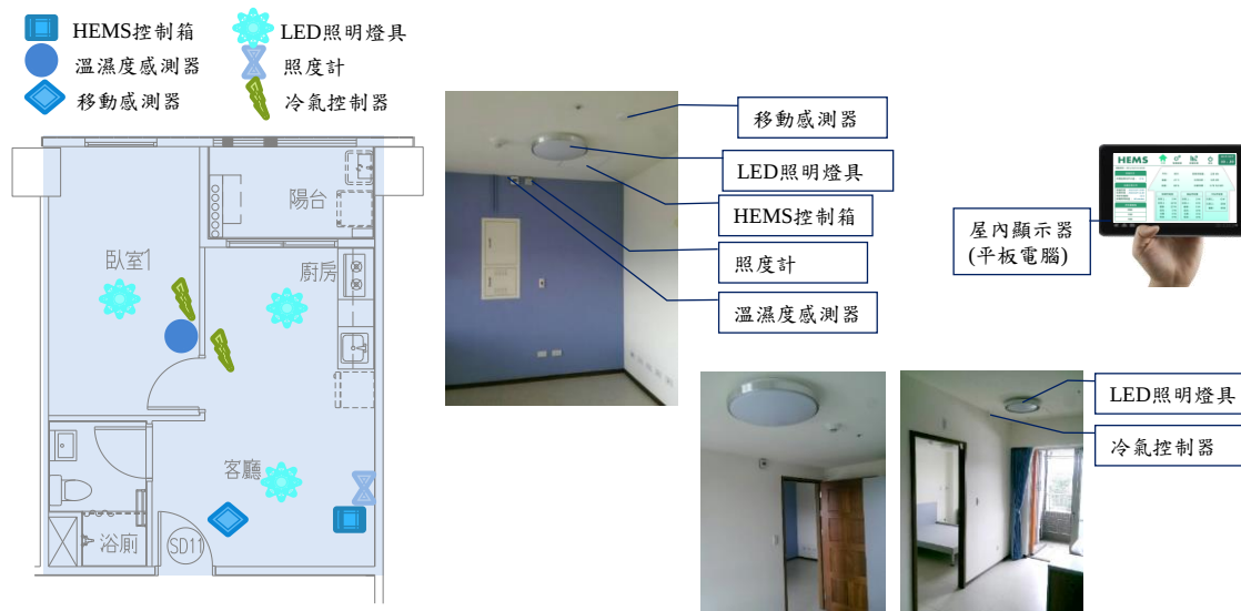
圖 3-3、一房一廳房型導入智慧家庭能源管理系統實景
