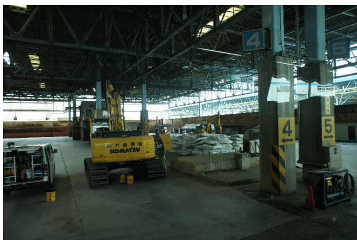
圖 三-24：巨大垃圾-塌塌米破碎處理情形
