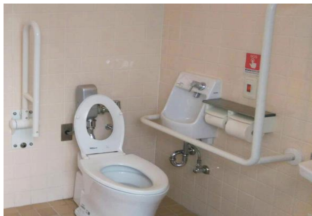
圖 四-13：多功能廁所內部設施
