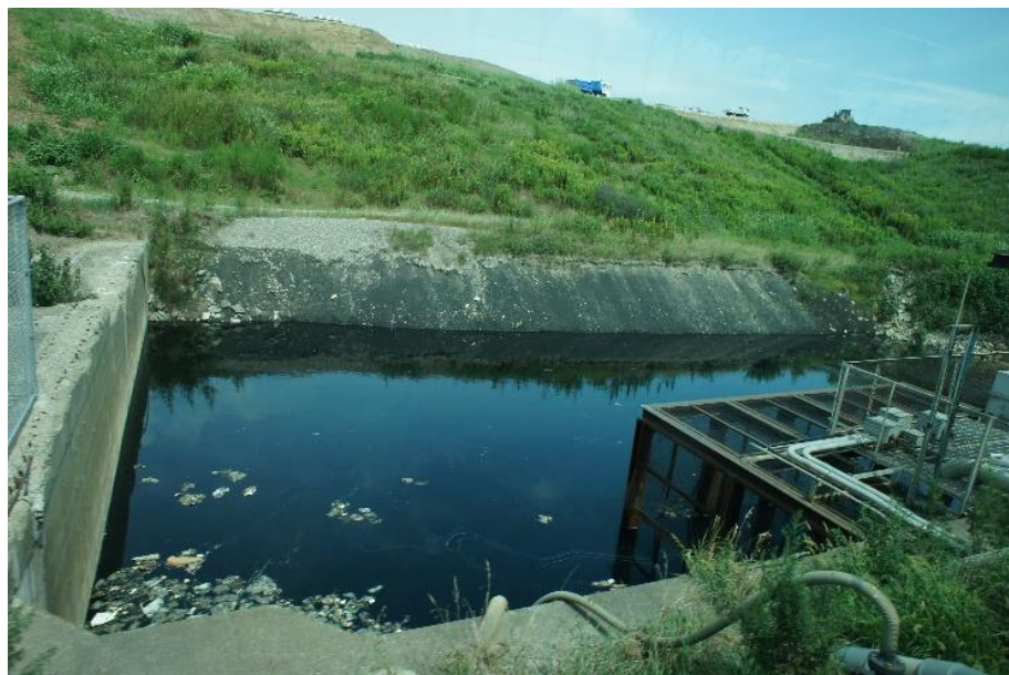
圖 三-32：掩埋區滲出水收集池集水情形
