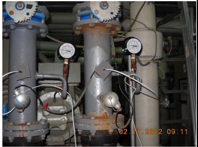
冰水主機冷卻水進出水溫量測
