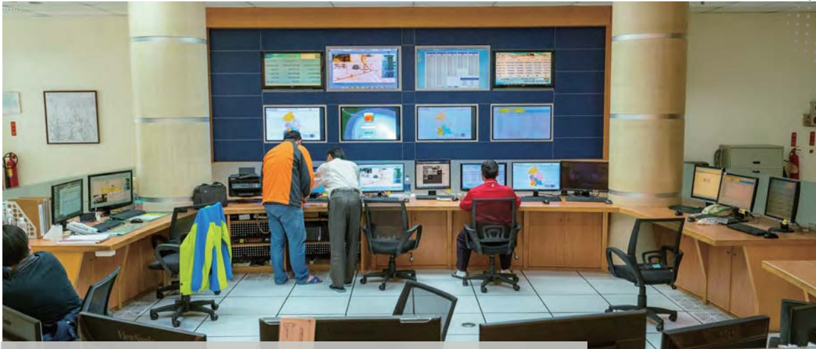
臺北自來水事業處監控中心。
