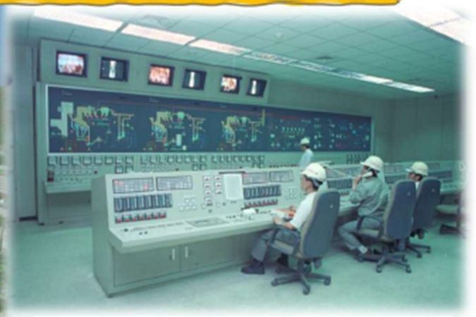
內湖焚化廠中央控制室操作營運
