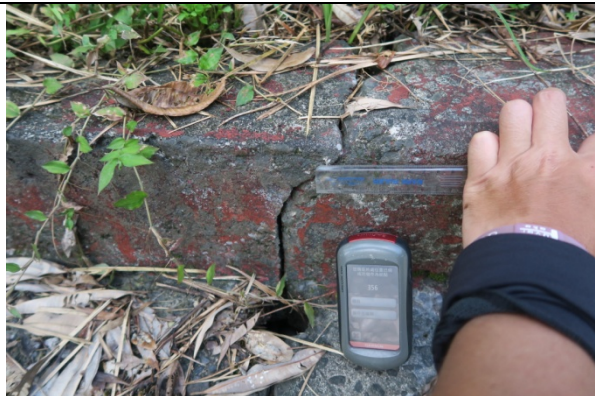
調查點 15: 地面水泥磚裂縫開裂 0.5 公分
