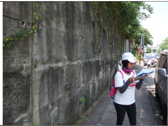
調查點 2: 邊坡保護工具橫向施工裂縫，寬 4~8 公分
