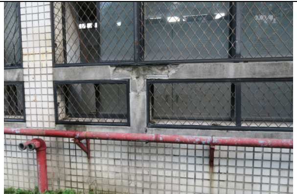
調查點 16: 建物水泥牆剝落
