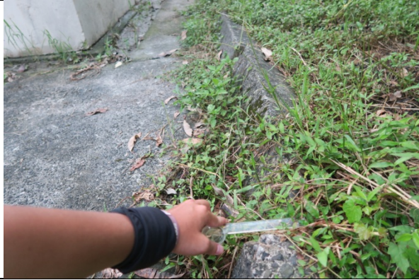
調查點 21: 第三階面地面水泥磚倒塌歪斜
