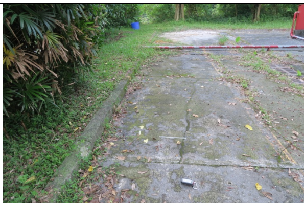
調查點 19: 第三階面地面水泥裂縫
