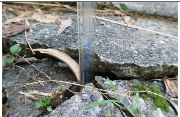
調查點 18: 地面因局部沉陷擠壓變形，裂隙長 5 公尺，寬約 5 公分
