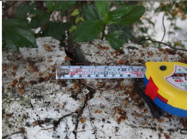
調查點 35: 第二階面西側水泥女兒牆土牆裂隙，裂隙長 1 公尺，開裂 2 公分
