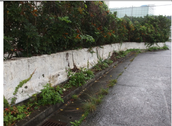
調查點 34: 基地西側道路駁坎局部有裂隙
