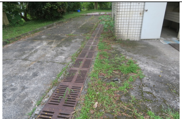
調查點 20: 第三階面地面水泥破裂凹陷
