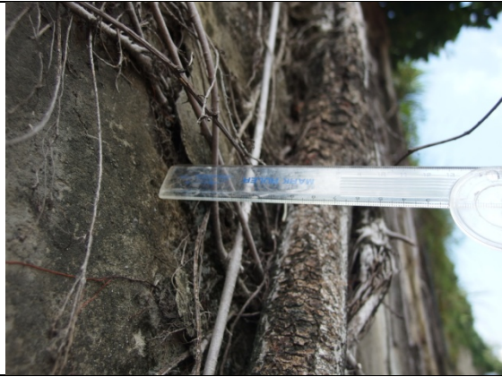
調查點 7: 第二階面南側下邊坡現況，擋土牆上面可見樹木盤據，排水系統略有阻塞
