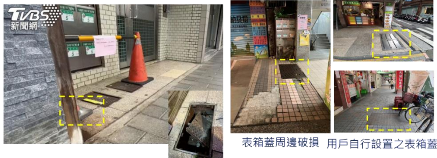
圖3：表箱蓋可能下陷、破損影響行人通行安全
