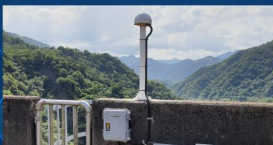
GNSS 高精度衛星定位設備
