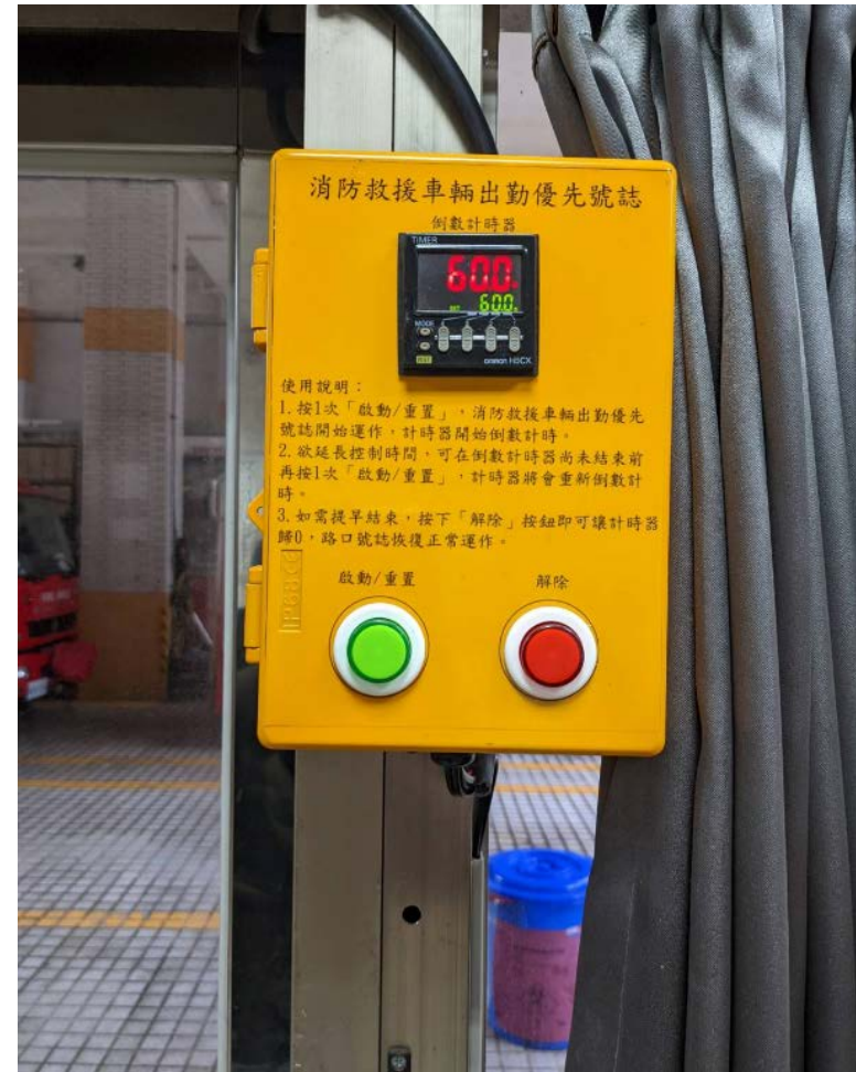
圖1 消防救援車輛出勤優先號誌設備
