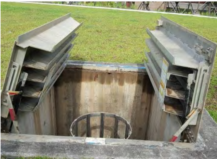
附圖9滯洪沉砂池完工後依需求調整維修孔蓋為千斤頂自動頂昇
