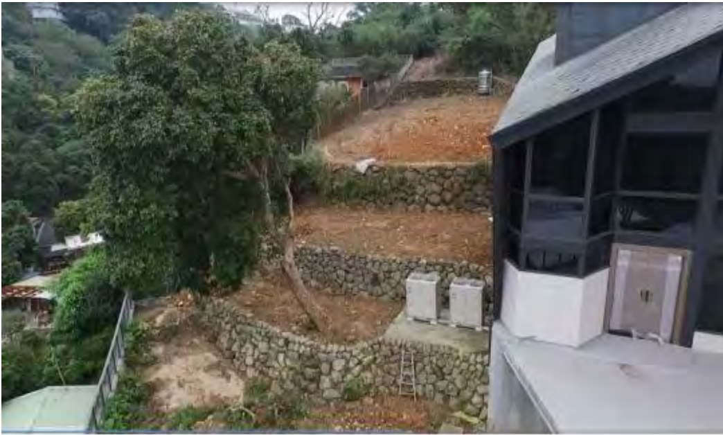
附圖6 擋土牆完工後遭破壞整地變更形式
