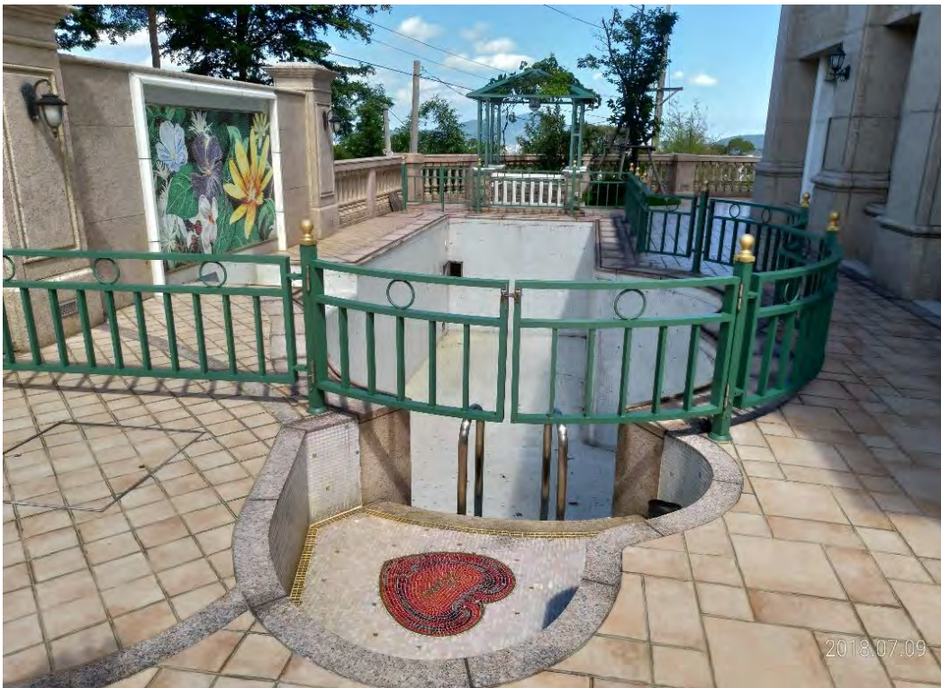
附圖5 滯洪沉砂池遭違規改建為游泳池
