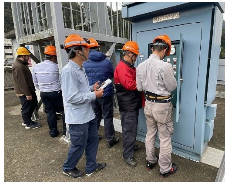
翡翠大壩水工閘門汛期操作測試
