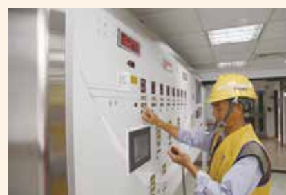
控制室值班人員遠端操控閘門
