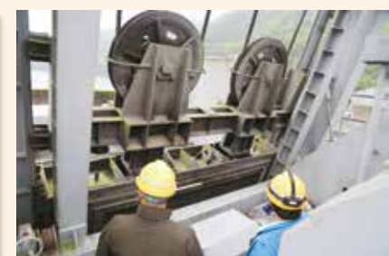
汛期前沖刷道擋水閘門試操作
