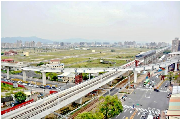
臺中線 CJ920 區段標北屯路松竹路口跨台鐵鋼構高架橋施工現況
