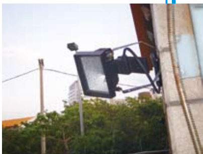
↑ 圖 8：端牆門外的投射照明燈
