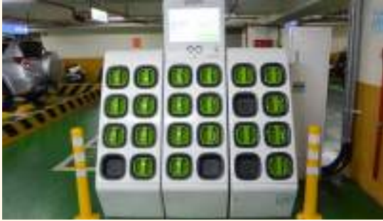
停車場提供電動機車電池交換站
