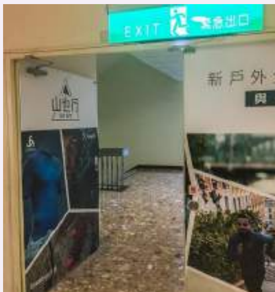
防火門保持暢通無封閉及損毀
