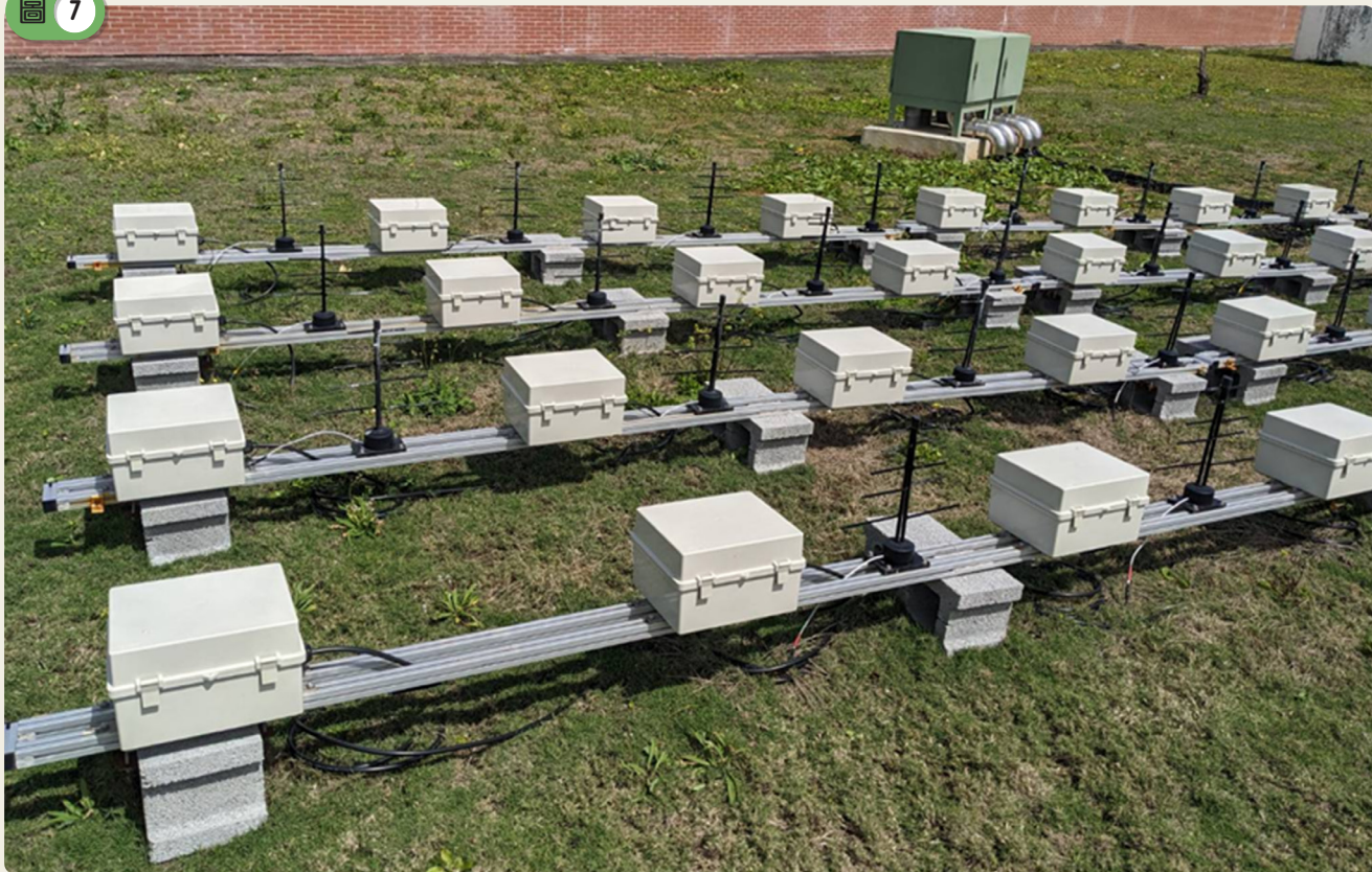
這是綠島輔助天線站的現場天線照片，白色盒子為天線的配線盒。現場配置為南北向四排，東西向一排，共計16支天線，總數為64支天線，構成干涉陣列。
