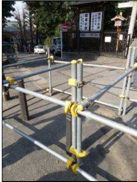
圖85 臨時性護欄之防止人員刮傷割傷之設施（護欄轉角及接頭皆設置塑膠防護）。
