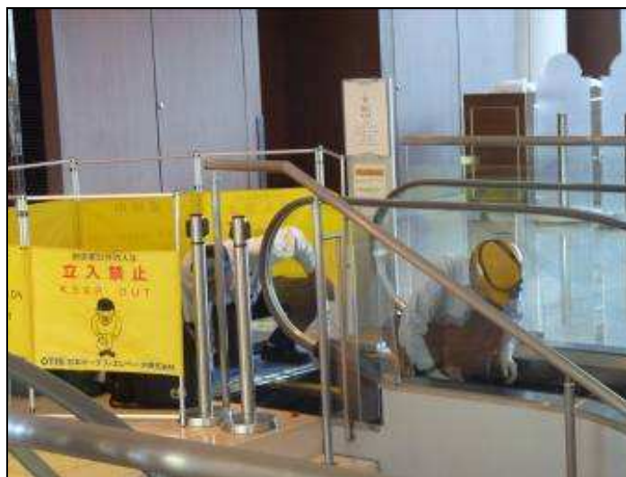
圖70 電扶梯維修作業（維修人員確實佩戴安全帽、檢視人員未佩戴安全帽）。
