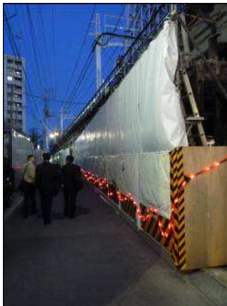
圖81 夜間行人通道臨時照明設備（簡易LED照明設備達到省電安全之效果）。
