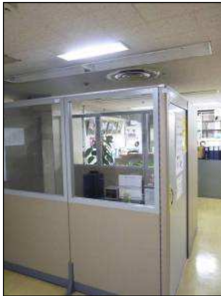
圖10 辦公室設置之吸菸區（上方有抽排風設備）。
