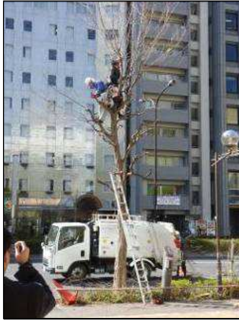
圖71 樹木裁剪作業未確實佩帶安全帶（本處建議以使用高空工作車較合宜及安全）。
