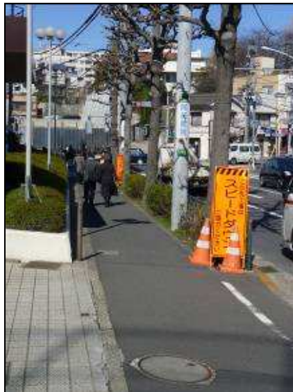
圖75 道路工程施作時前方之警告標示牌（依規定佔用道路作業前方特定距離擺設警告標示供行車車輛注意）。
