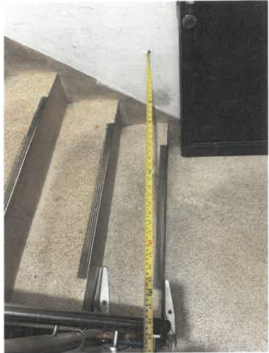
改善計畫及竣工成果：1樓新設樓梯附掛式升降椅
