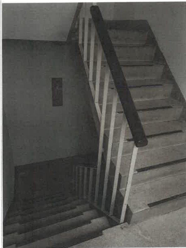
3. 現況：2樓無升降設備
