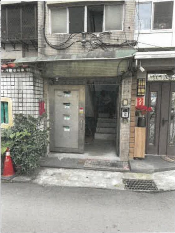
現況：高低差14公分未設置斜坡道
