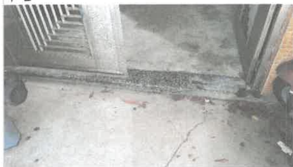
現況：2(2)1F 1樓避難層坡道及扶手高差7公分、未設坡道。避難層出入口未設置平台。
