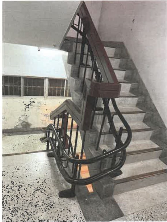
改善計畫及竣工成果：2樓新設樓梯附掛式升降椅
