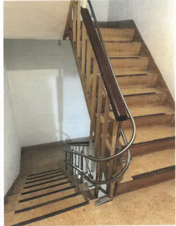
改善計畫及竣工成果：3樓新設樓梯附掛式升降椅
