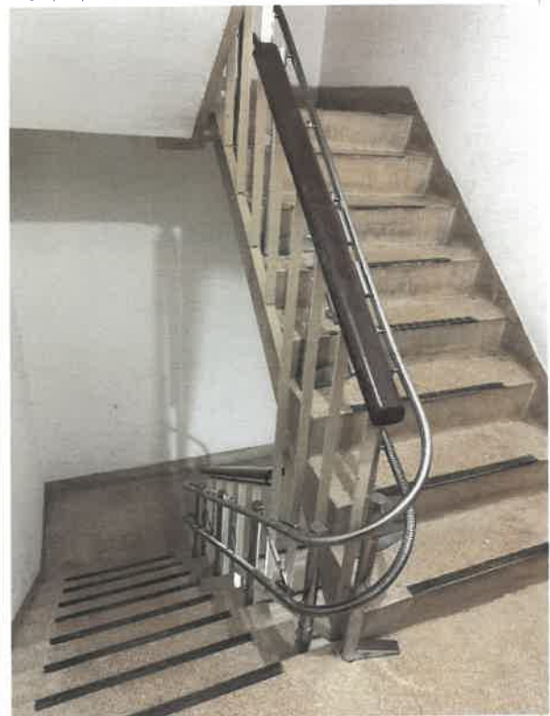
改善計畫及竣工成果：2樓新設樓梯附掛式升降椅
