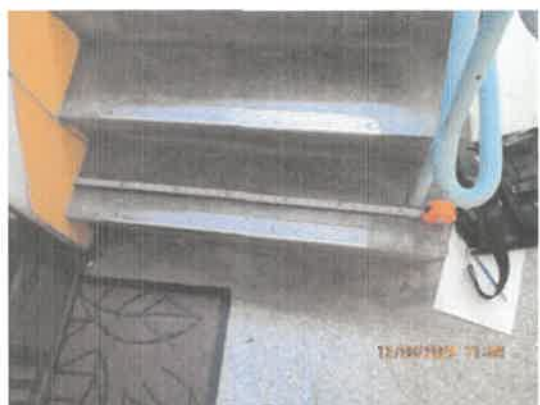
現況：2樓往中間平台階梯寬度95cm
