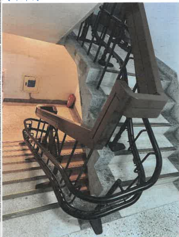
改善計畫及竣工成果：1樓新設樓梯附掛式升降椅
