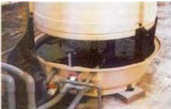
照片1-9 屋頂空調冷卻塔
