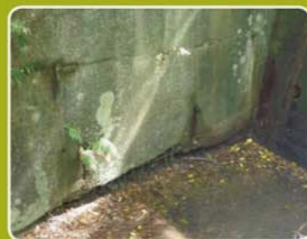
▲人工邊坡坡趾掏空
