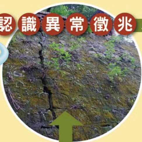
▲人工邊坡出現裂痕
