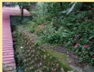
▲排水溝阻塞及破損
