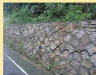
▲人工邊坡出現裂縫
