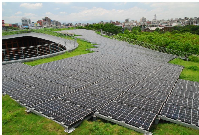
花博未來館太陽光電設備
