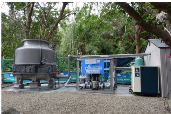
北投泉源47號公園地熱發電機組
