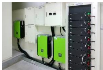
地下室機電空間裝設儲能系統
