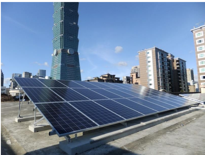
信義國小設置太陽光電發電系統
