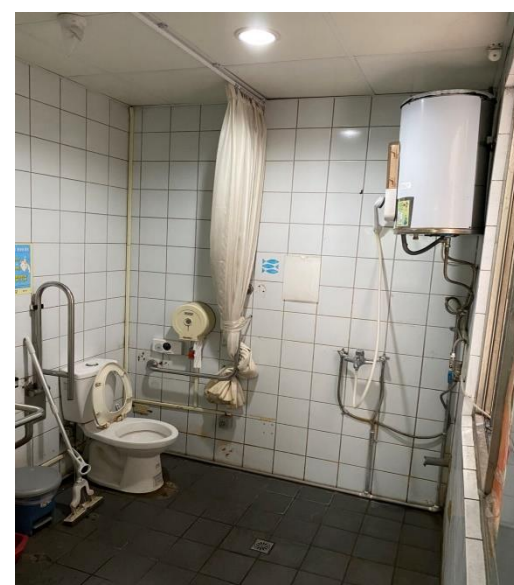
說明：防災館設置無障礙廁所
