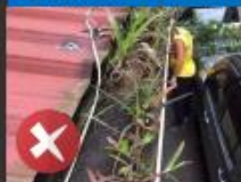
屋簷的排水槽年久淤積堵塞，容易產生積水
