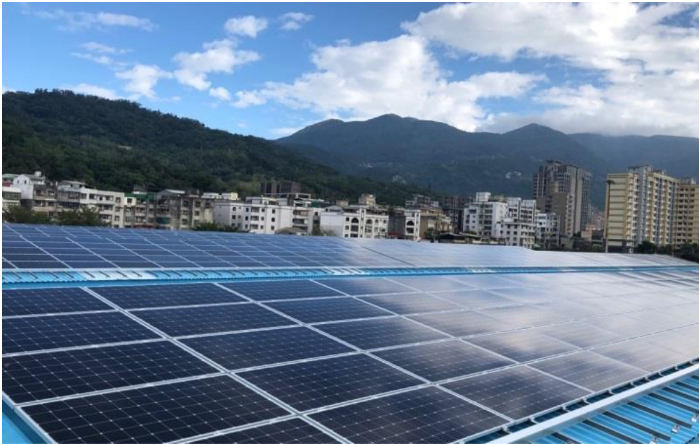
照片 10 北投機廠屋頂設置太陽能商業運轉
