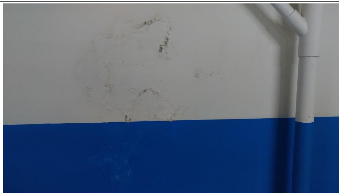
B2F 9 號停車格後方牆面表層壁癌處理油漆復原
