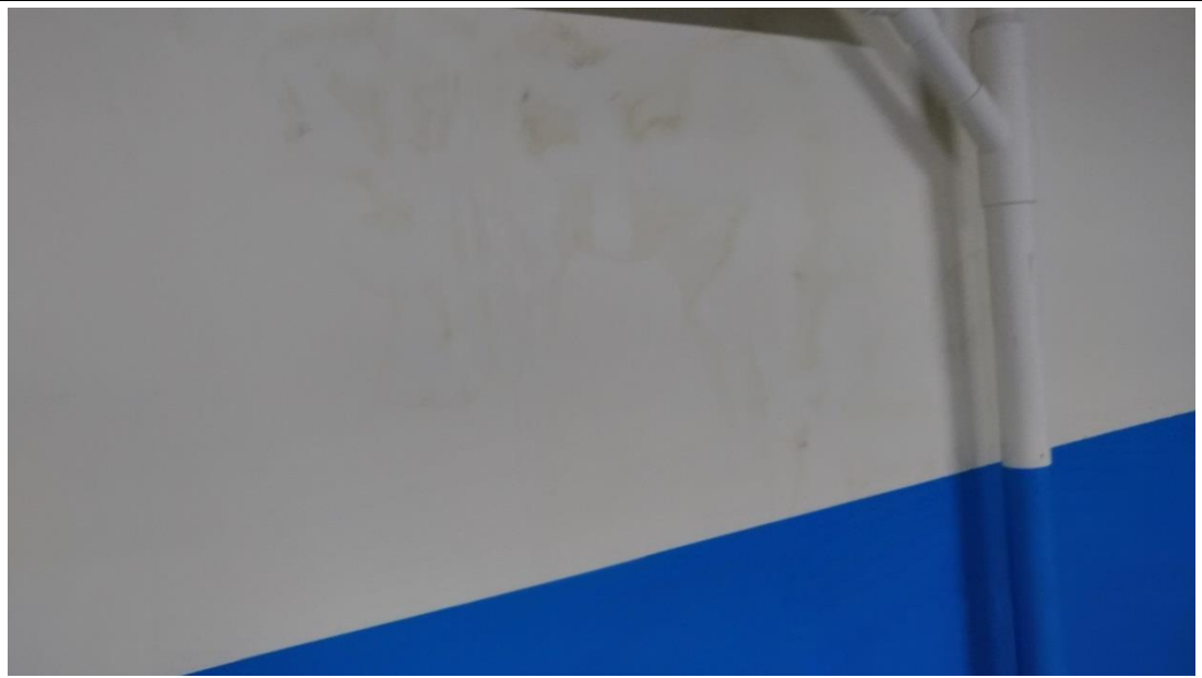
B2F 12 號停車格後方牆面表層壁癌處理油漆復原
