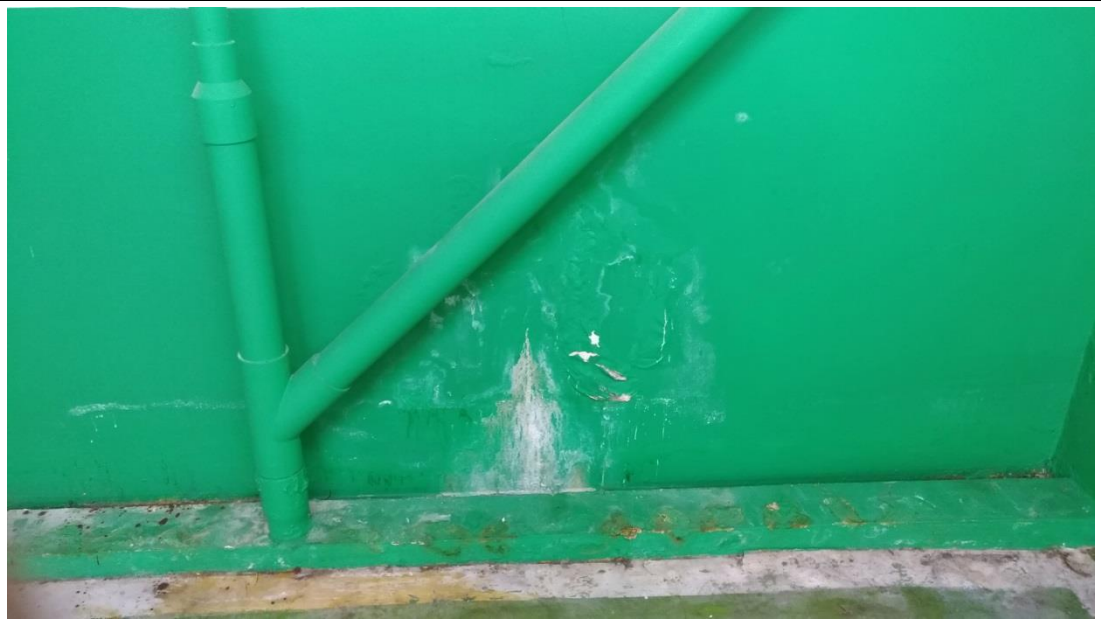
B3F 40 號停車格後方牆面表層壁癌處理油漆復原
