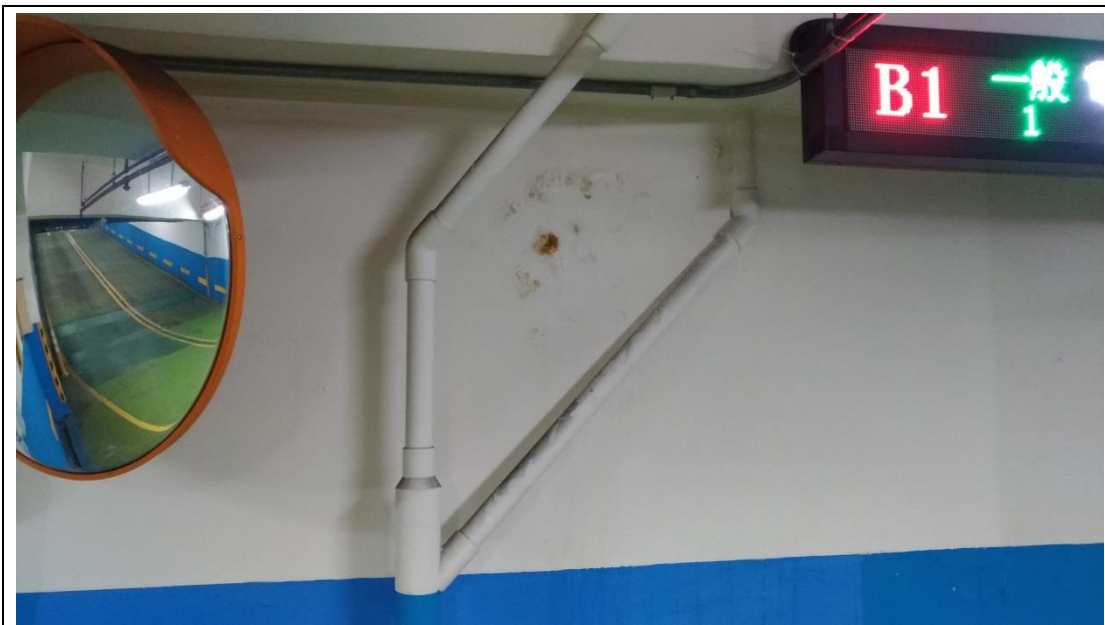
B2F 1 號停車格前方右側牆面表層壁癌處理油漆復原
