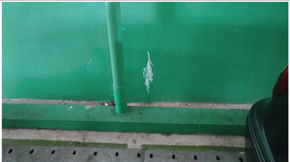
B3F 60~61 號停車格後方牆面表層壁癌處理油漆復原
