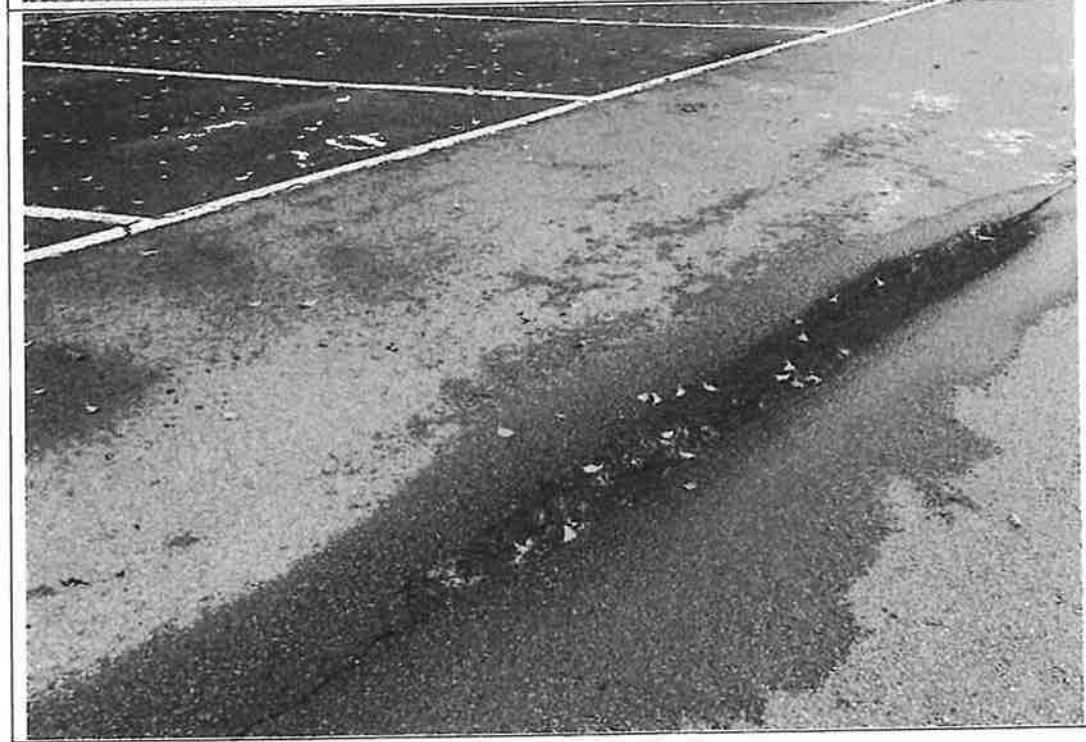
AC 鋪面坑洞不平整
