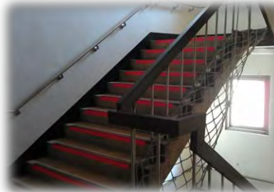
樓梯間不鏽鋼扶手(含安全網)
