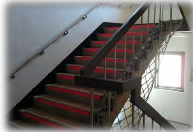
樓梯間不鏽鋼扶手(含安全網)
