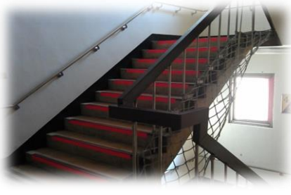
樓梯間不鏽鋼扶手(含安全網)
