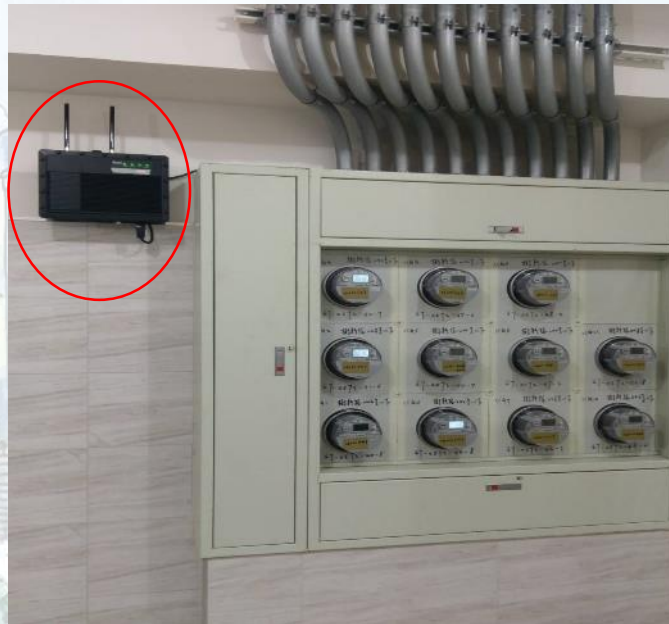
電表位於地上層
