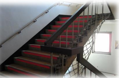
樓梯間不鏽鋼扶手(含安全網)
