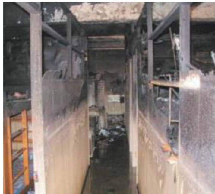
採用易燃材料裝修，一旦火災即釀成鉅禍
