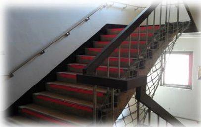
樓梯間不鏽鋼扶手(含安全網)
