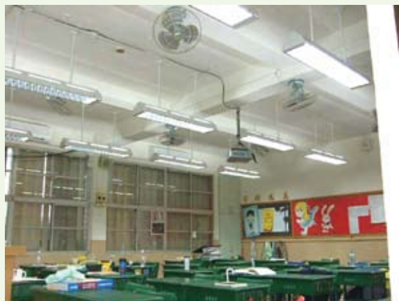
▲教室內安裝T5燈具後減少眩光發生
