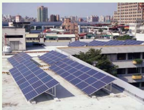
▲萬福國小新設置之太陽能光電板頂樓樣貌
