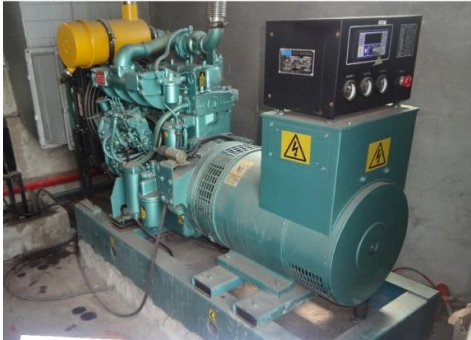
緊急供電系統
