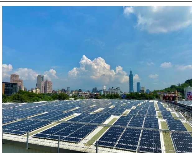
長興淨水廠設置太陽光電
