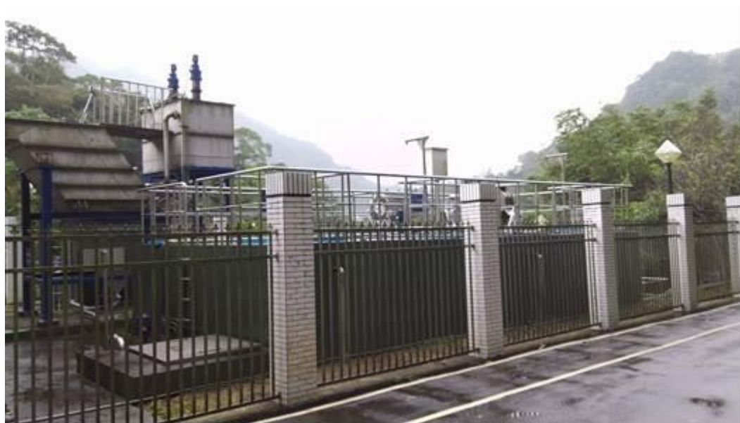
金瓜寮小型污水處理廠
