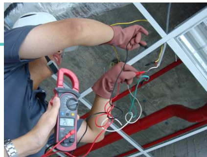
本處派員至現場以三用電錶量測燈具線路與輕鋼架之對地電壓為282伏特
