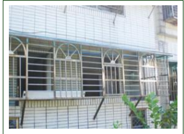
▲ 外牆裝設柵欄式防盜窗，其尺寸及透空率均應符合規定，並留設有效開口
