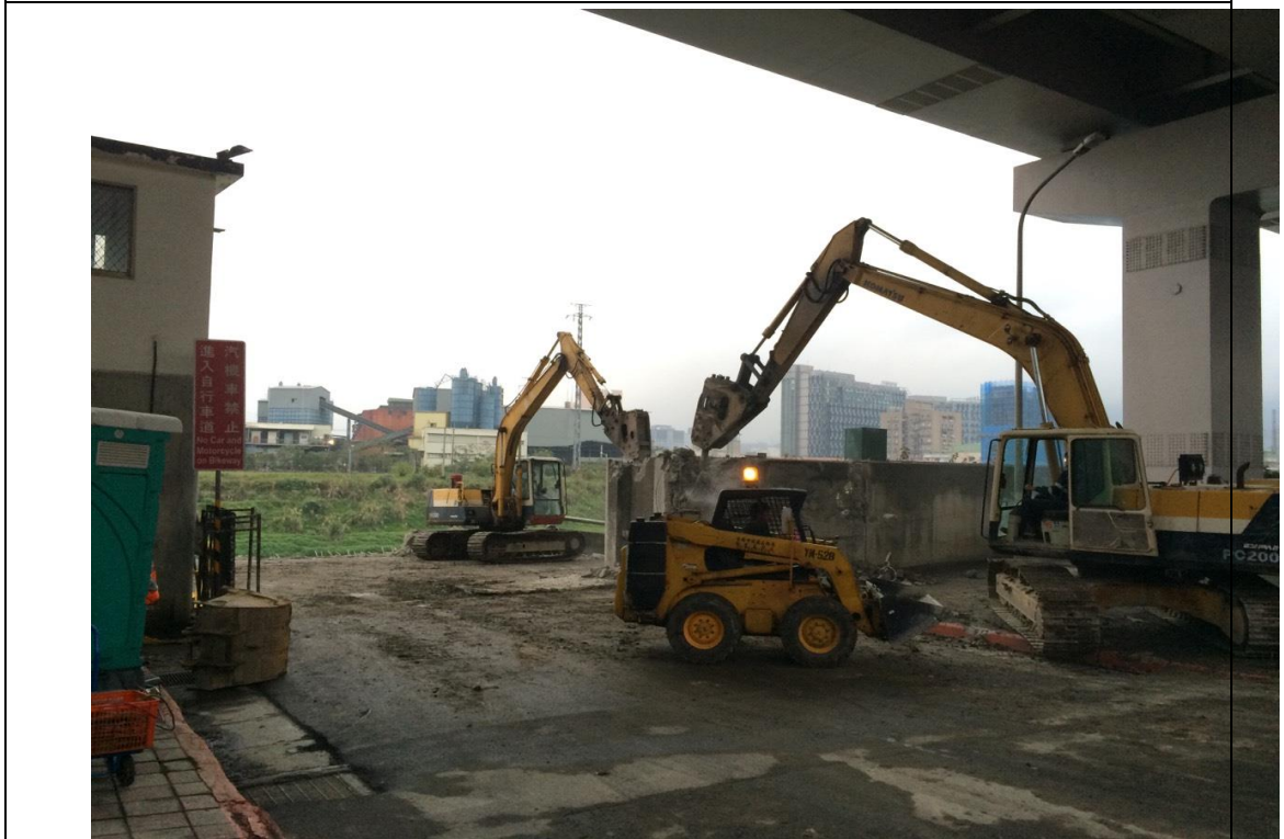
挖溝機破壞基一號疏散門
