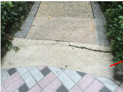
B.部份鋪面破損，易造成危險且不美觀。
