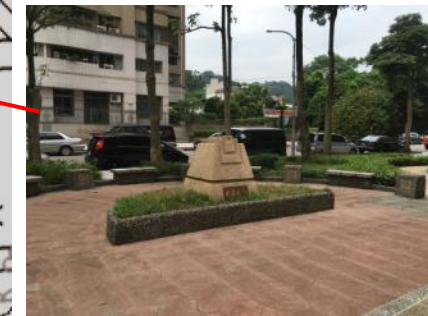
D.廣場區為壓花地坪，有破損之情形。
