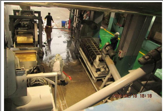
圖 3. 廚餘前處理設施作業現況
