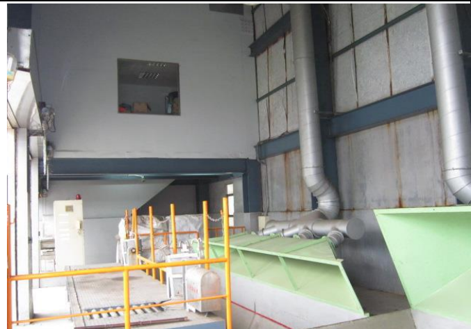
圖 4. 廚餘前處理設施作業現況
