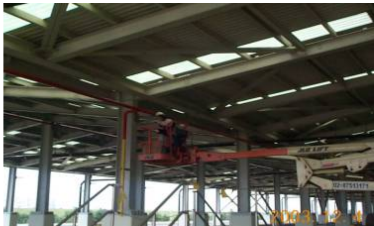
CD550區段標捷運CD314標土城機廠駐車廠消防配管
