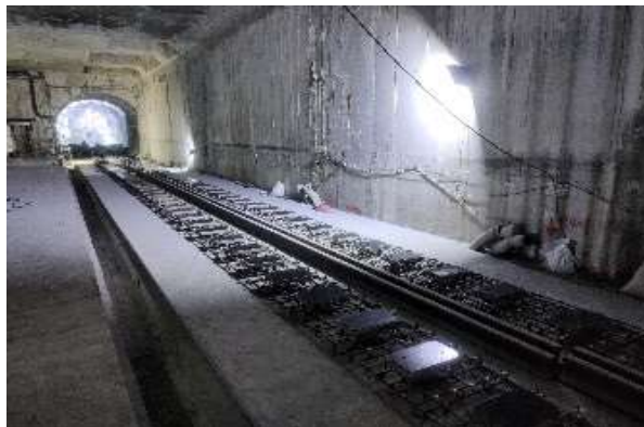
信義線東延段工程象山站尾軌無道碴道床混凝土基座施築施工現況
